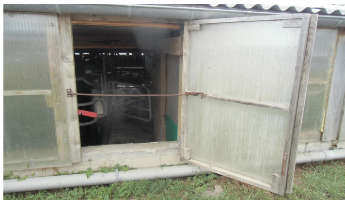
Ventilation salle de traite.
